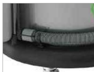
MANGUERA DE DRENAJE
